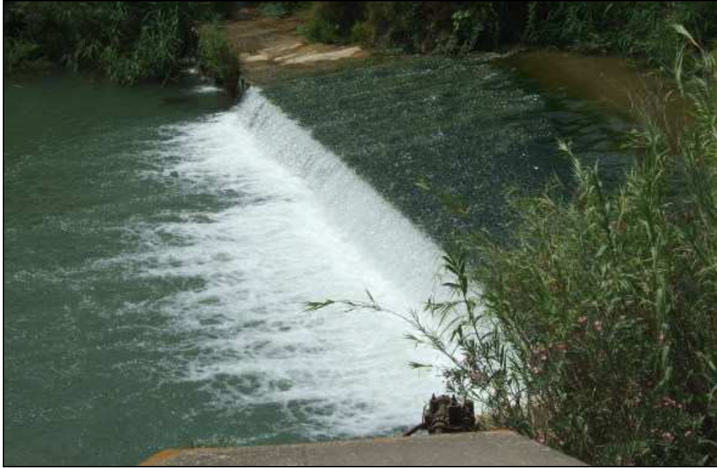
Fotografía 4.3. Punto de carga en el río Turia, pequeño azud ubicado en el término municipal de Benaguasil.
